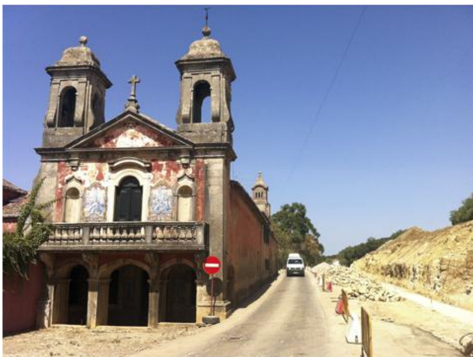
“Alargamento da Estrada de Manique de Baixo junto à Quinta de Manique” (Obra C.M.C.)
